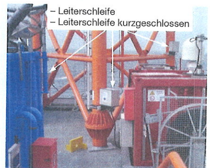
6 Leiterschleifen am Turmfuß
