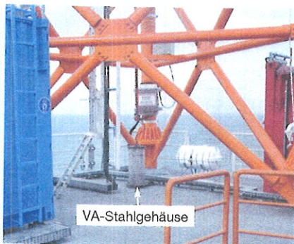
5 VA-Stahlgehäuse am Turmfuß
